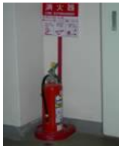
しょう か き 消 火 器
