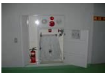
おくないしょう か せん 屋 内 消 火 栓
